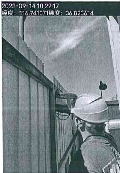
1#燃气轮机组排气筒
