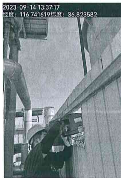
2#燃气轮机组排气筒
